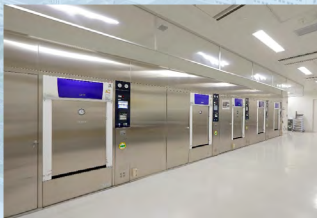
(2階) 材料部・滅菌装置
